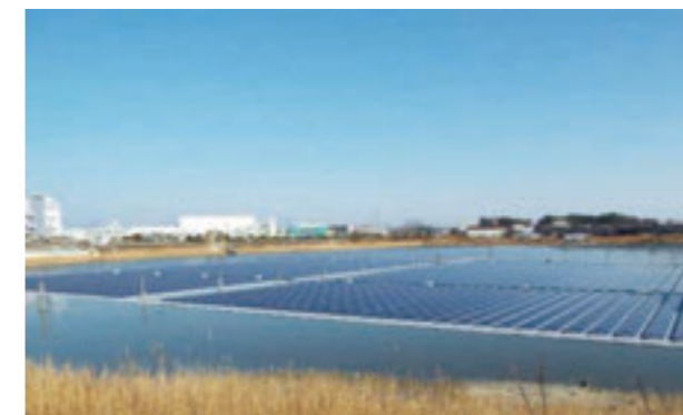
水上フロート式太陽光発電所(認定出力1.99MW)
