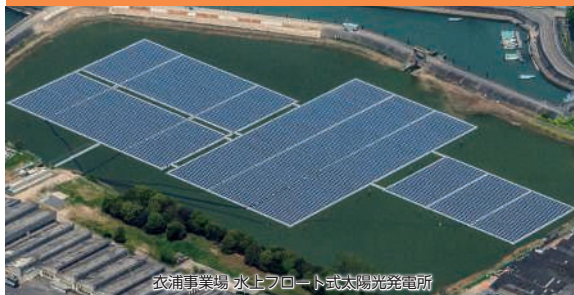
衣浦事業場 水上フロート式太陽光発電所
