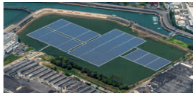
水上フロート式太陽光発電所(認定出力1.99MW)
