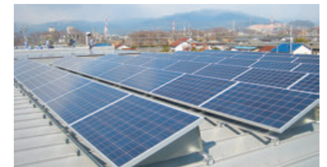
太陽光発電設備
