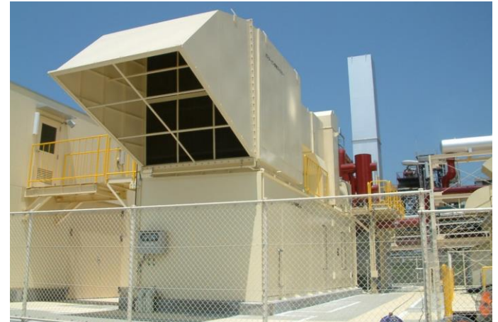
大垣事業場 コージェネレーションシステム
