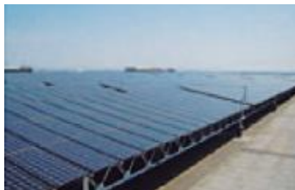
太陽光発電システム 当社の事業場構内に太陽電池パネルが設置され、稼働しています。
