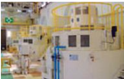
水力発電 揖斐川上流で三つの水力発電所（広瀬・川上・東横山水力発電所）が稼働しています。
