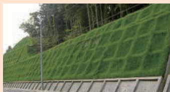
のり面事業(GTフレイム工法) [イビデングリーンテック(株)]
