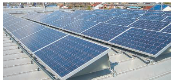
太陽光発電設備
