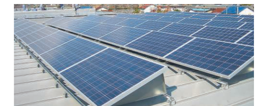
太陽光発電設備
