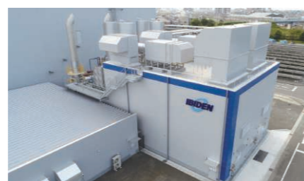
コージェネレーションシステム(大垣中央事業場)
