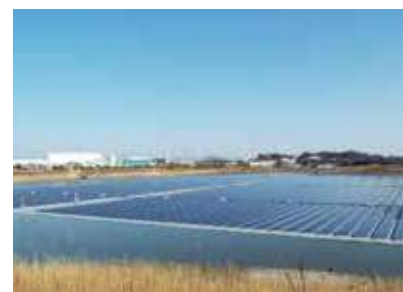
水上フロート式太陽光発電 (衣浦事業場 貯木場跡地)
