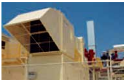
コージェネレーションシステム 当社の事業場構内でコージェネレーションシステムが稼働しています。
