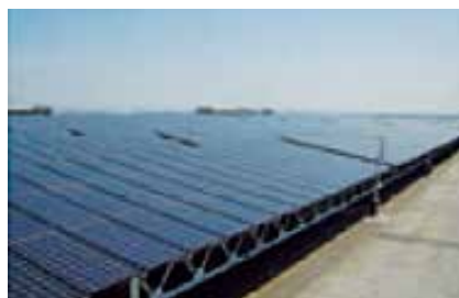
太陽光発電システム 定格発電出力647キロワットの太陽電池パネルが本社・大垣中央事業場に設置されています。
