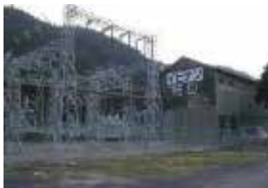
広瀬水力発電所（2012年度更新完了） 発電能力 8,900キロワット
