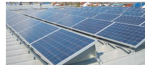
太陽光発電設備
