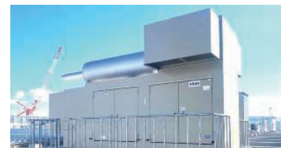
非常用発電設備(大野事業場) [イビデンエンジニアリング株式会社]
