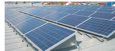
太陽光発電設備
