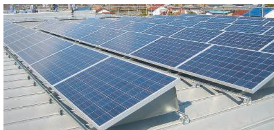
太陽光発電設備
