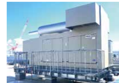
非常用発電設備 (大野事業場) 【イビデンエンジニアリング株式会社】
